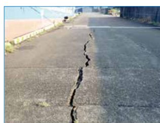
【第5・6岸壁のクラック】
