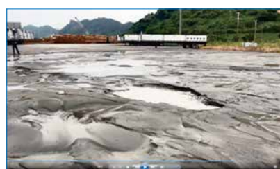
【油津港第9岸壁背後の液状化】
